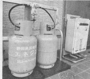
小型ガスボンベで動く仮設給湯器の設置サービスが強み（2月、浜松市）
